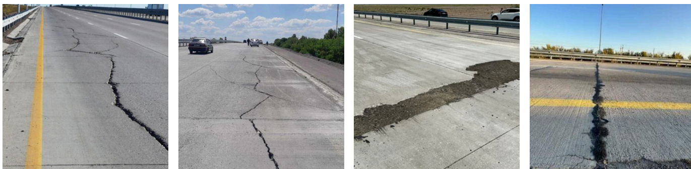
Рисунок 1 – Примеры дефектов на цементобетонных покрытиях
