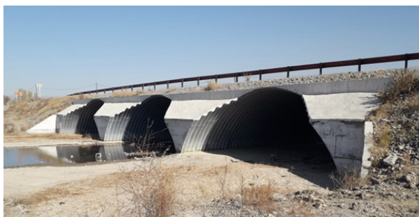
Рисунок 1 - Общий вид моста через реку Карачик км 8+850 дороги Р-31 «Кентау – Туркестан – Шаульдер – Тортколь»
